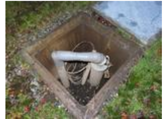
沖駒地区において個別設置された深井戸
